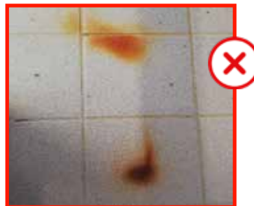
Fig. 7 | Macchie di ruggine
