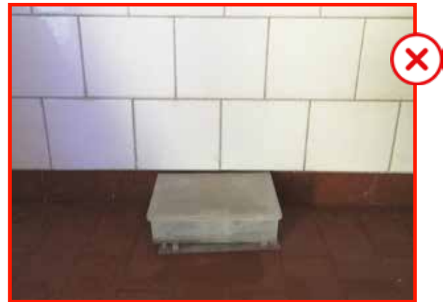
Fig. 30 | Dispositivo di monitoraggio non identificato
