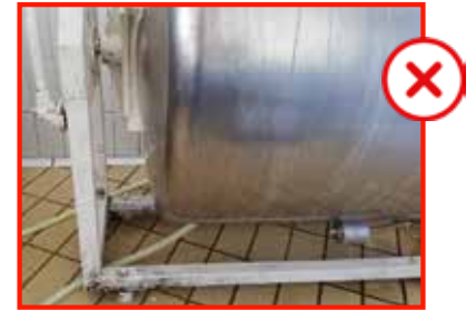
Fig. 15 | Presenza di ruggine e/o sfaldatura della vernice coprente
