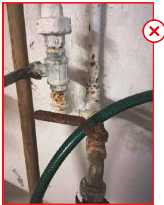
Fig. 32 | Rubinetti in cattivo stato di manutenzione
