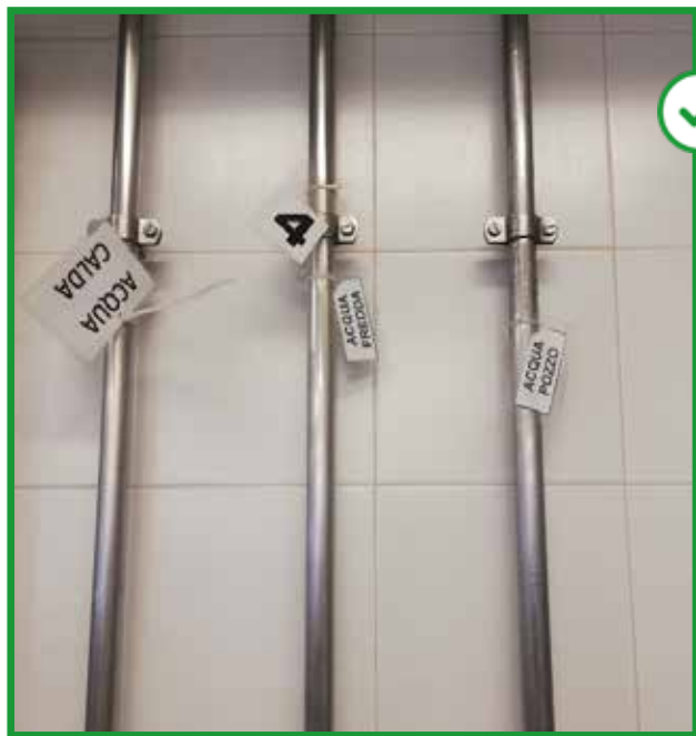
Fig. 31 | Distinzione tra tubature con identificazione del punto acqua
