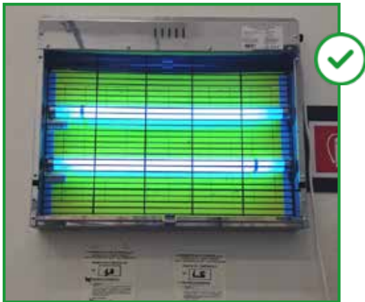
Fig. 29 | Lampada UV pulita e correttamente identificata
