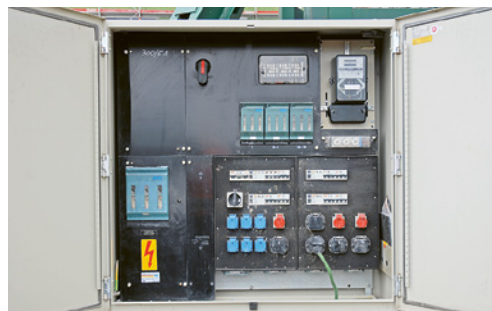
5 L'allacciamento dei quadri di distribuzione deve essere eseguito solo da installatori concessionari.
