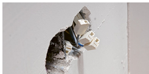
8 Cavi elettrici isolati che fuoriescono dalla parete.
