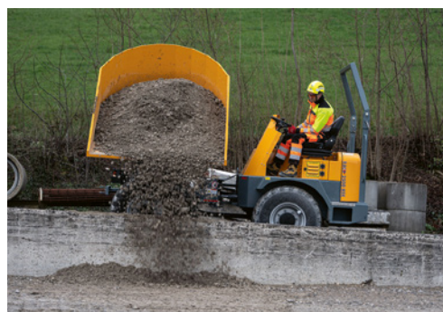
3 Punto di scarico con elemento di protezione anticaduta (almeno 1/3 dell'altezza delle ruote) per evitare che si superi il bordo della scarpata.
