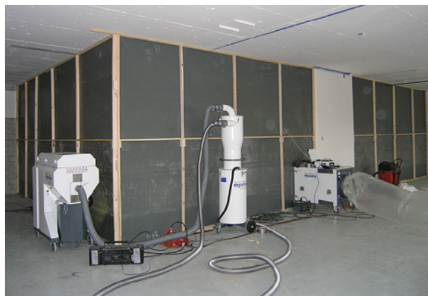
3 Separatori di polveri e apparecchio per il mantenimento della depressione
