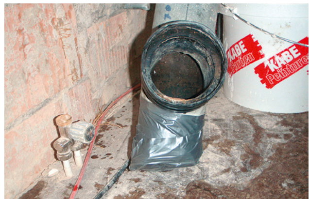
4 Tubo pronto per lo smaltimento, con estremità sigillata mediante nastro adesivo
