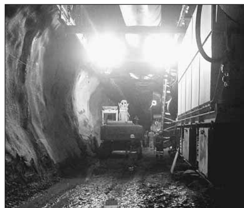
Foto 1: situazione di pericolo per il personale a causa dello spazio ristretto durante il brillamento di mine.
