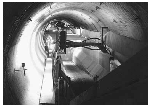
Foto 2: quando si pianifica l'opera e le installazioni bisogna considerare quanto spazio si ha a disposizione.
