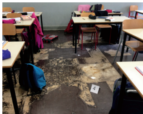
Aula con piastrelle in cattivo stato di conservazione
