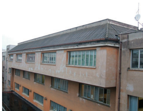
Tettoia non raggiungibile presumibilmente costituita da cemento amianto
