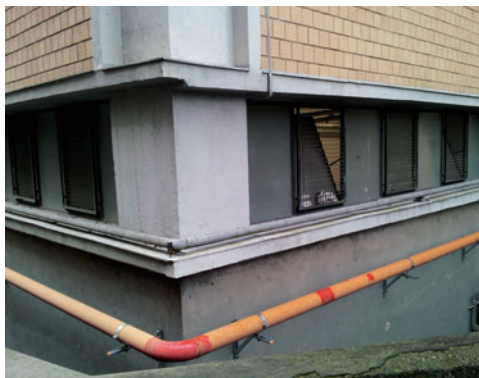
Soglie in cemento amianto nel perimetro dell'edificio
